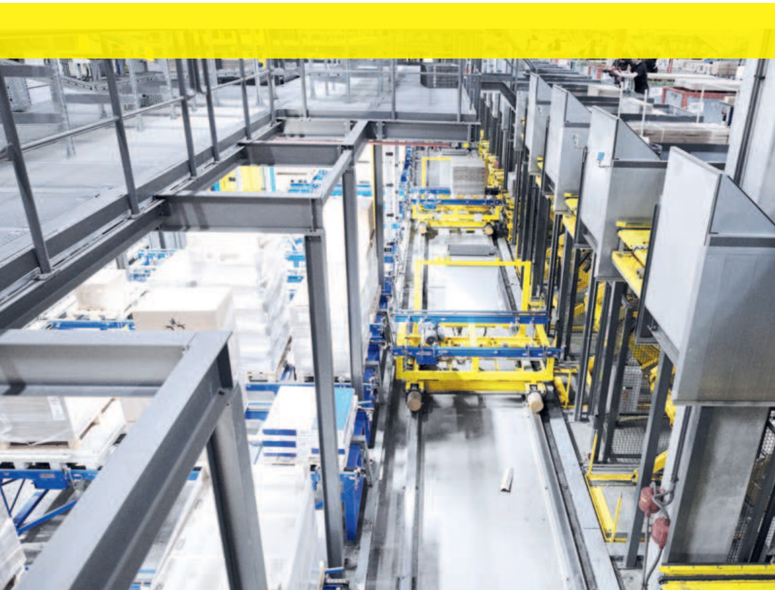
Ergonomische Kommissionierung ausgelagerter Paletten
