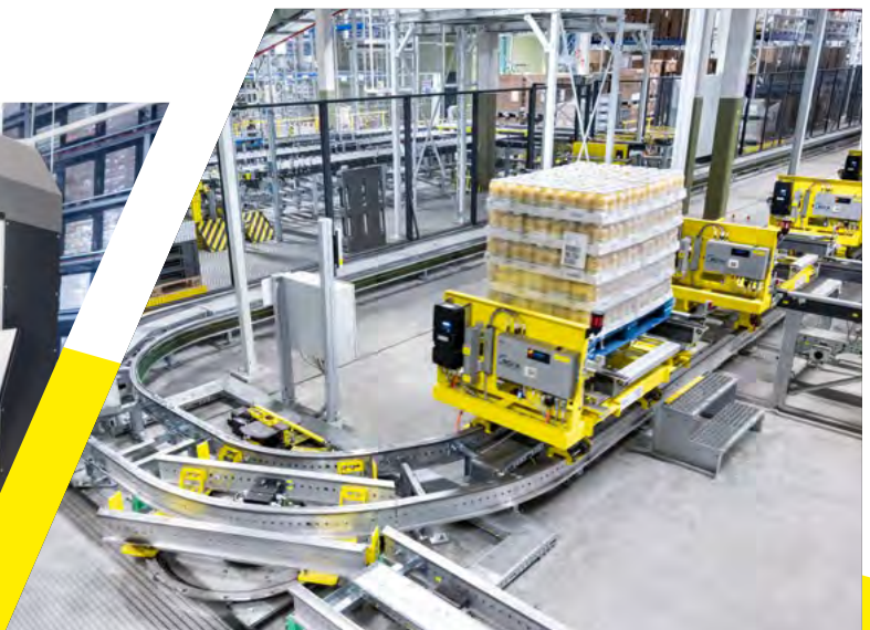
Transport zur Depalettierung auf Elektrobodenbahn
