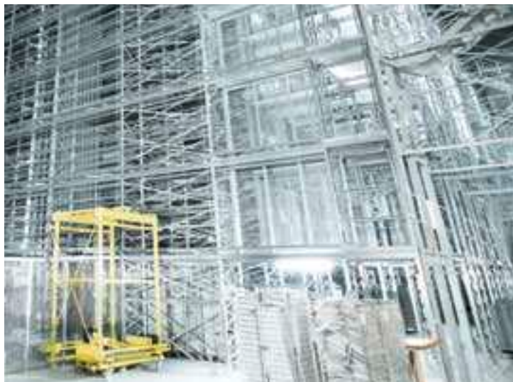
Shuttle-Lager mit 130.500 Behälterstellplätzen
