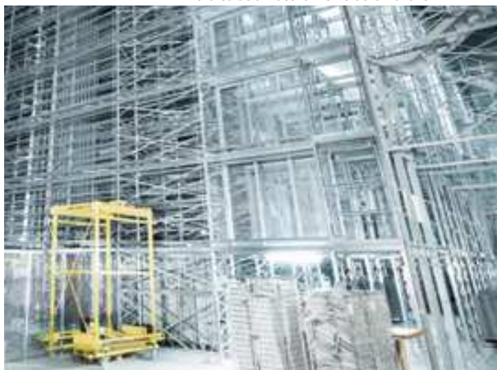
Zona de la Navette con 130.500 puntos de almacenaje de cajas
