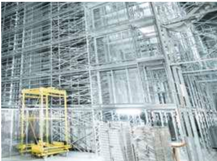
Shuttle-Lager mit 130.500 Behälterstellplätzen
