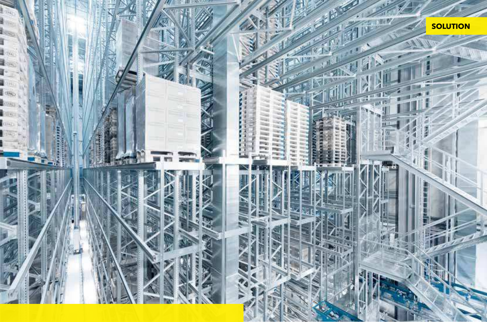
L'entrepôt grande hauteur à 3 allées peut accueillir 6.300 palettes
