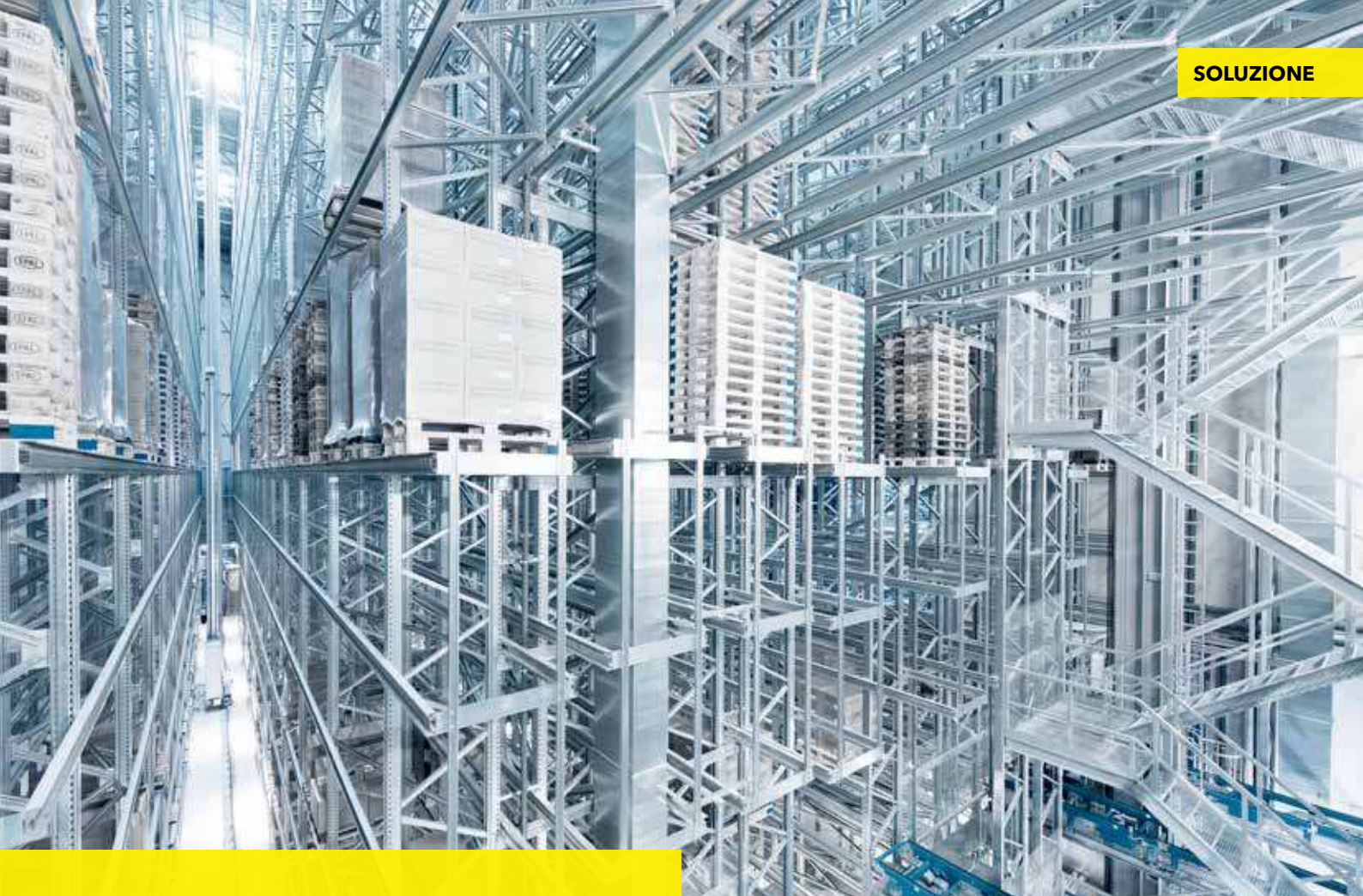
6.300 pallet trovano posto nel magazzino verticale a tre corsie
